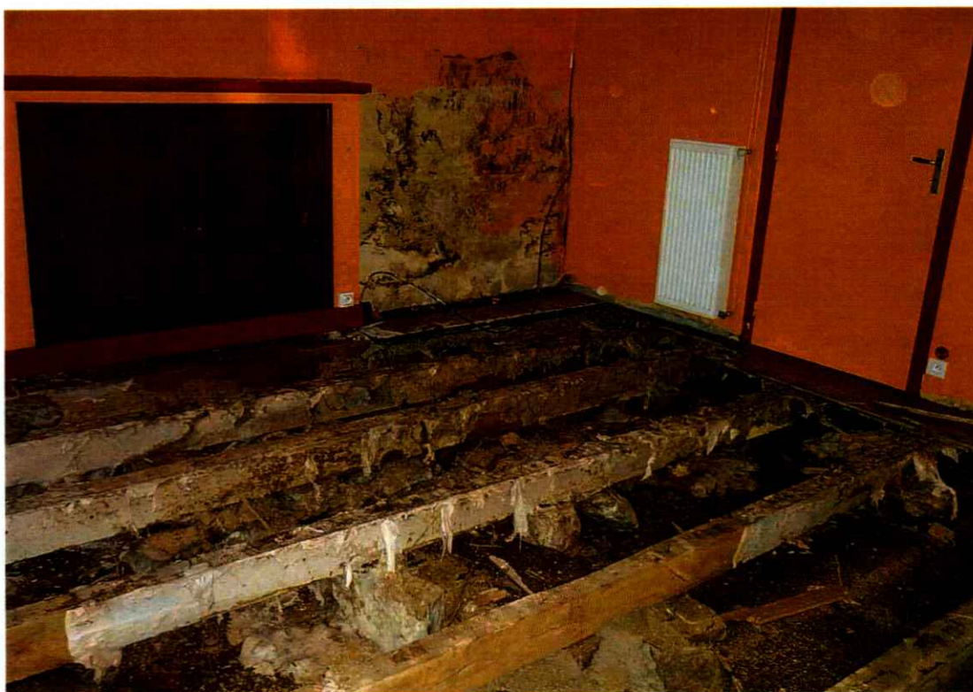
Mérules qui se sont développées dans le plénum d'un plancher bois, constatées après dépose du plancher
