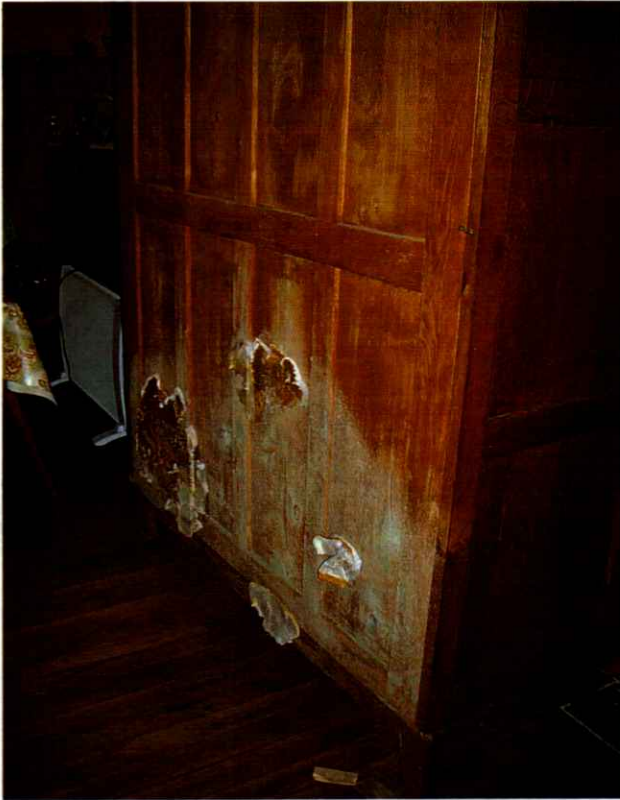
Mérule qui s'est développée derrière une armoire plaquée contre un mur
