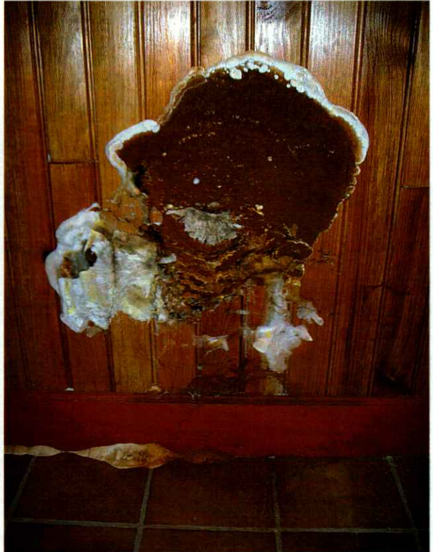
Mérule qui s'est développée sur le lambris d'habillage du mur contre lequel était placée l'armoire
